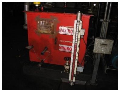
Estanque Hidráulico MP
